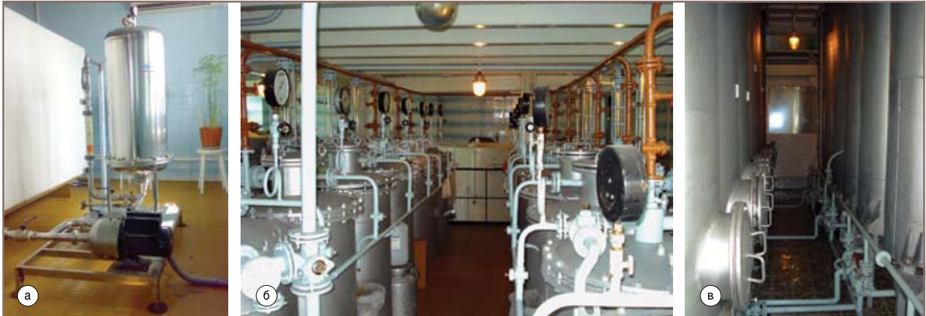
Рис. 2. Установка серебряной фильтрации (а) заменяет батарею угольных колонн (б, в) в очистном отделении (ОАО «ВладАлко», г. Владимир)
